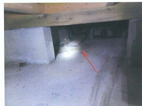
⑤風呂場下の水漏れ痕
