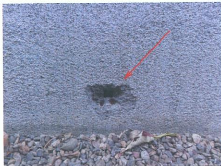
①基礎の剥落
