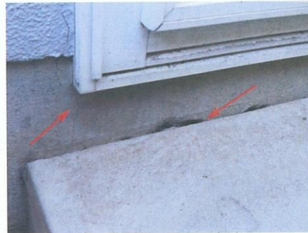
②基礎のクラック・足場剥離
